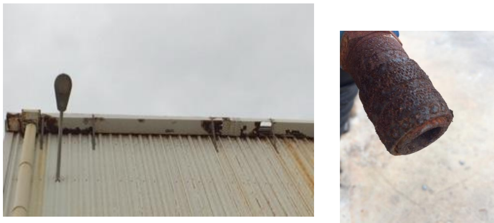
Figura 1 – Exemplos de corrosão atmosférica no Porto do Açú.
