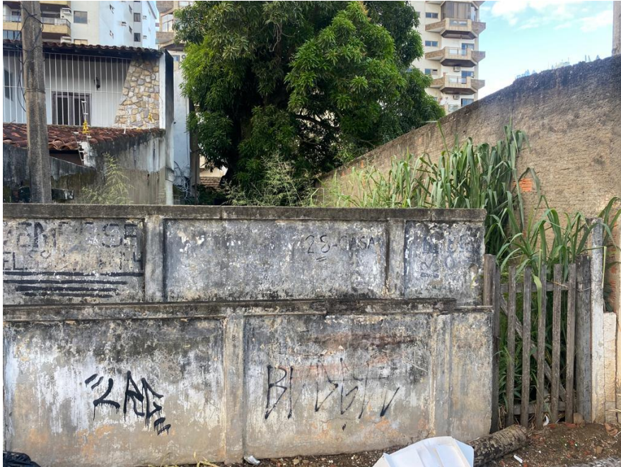
Figura 4 – Imóvel abandonado na Rua Campos Sales
